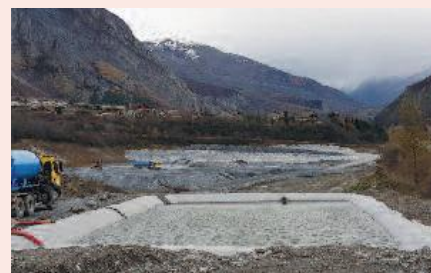
Vue d'ensemble du lieu de stockage définitif.
